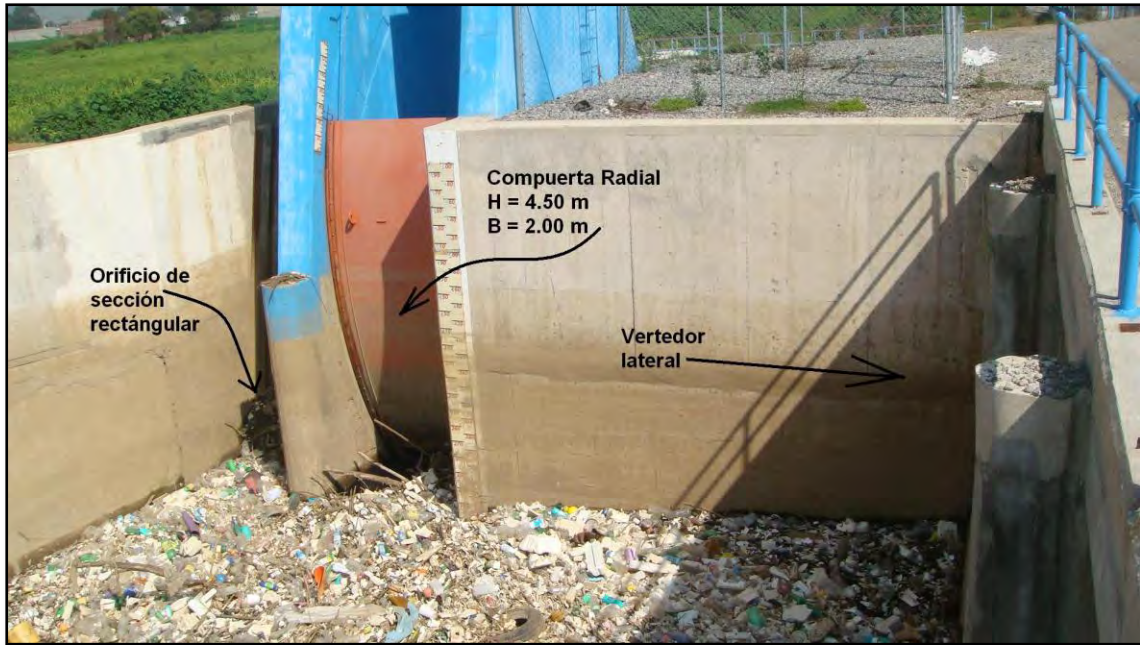
Fig 1.5.- Compuerta radial de la derivadora San Rafael.
