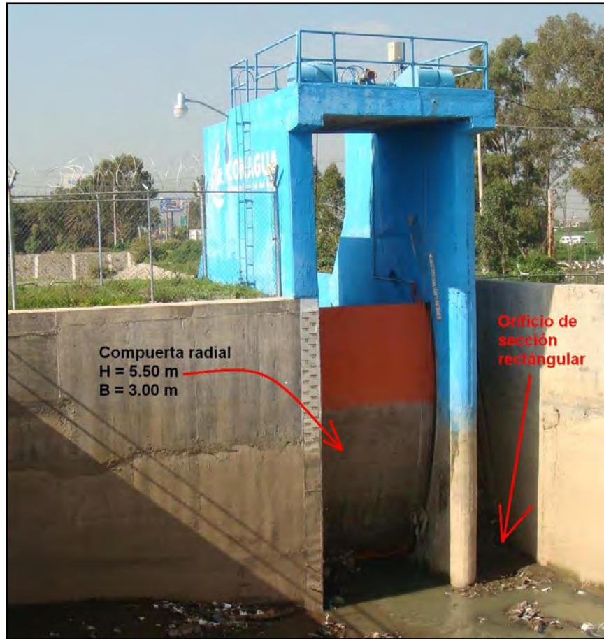
Fig 1.11.- Compuerta radial de la derivadora San Francisco
