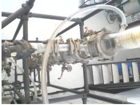
Manguera tramada blanca para vacío, domo de torre.
