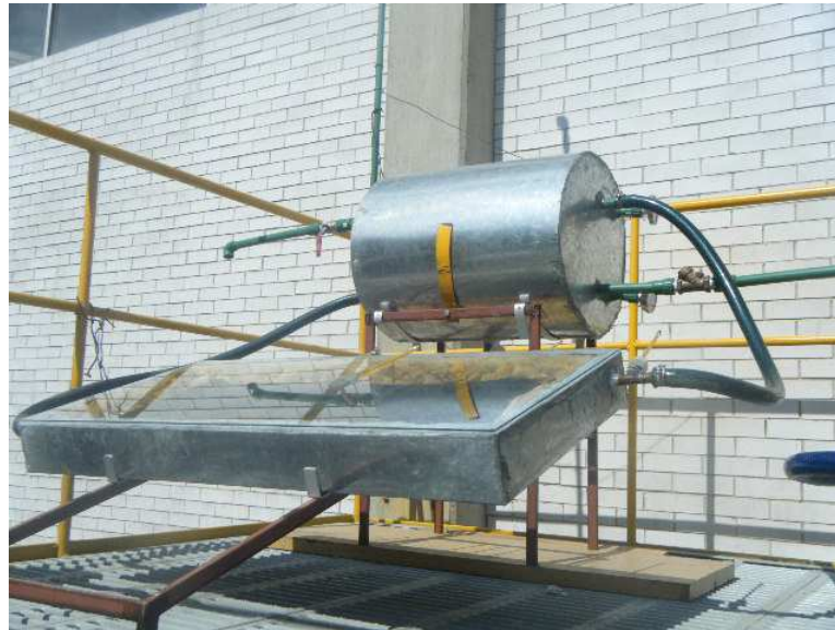
Figura 3.3 Sistema colector instalado en FES Zaragoza Campo II
