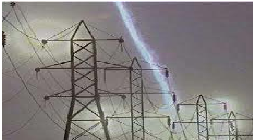
Figura IV. 2 Torres de alta tensión golpeadas por un rayo.
