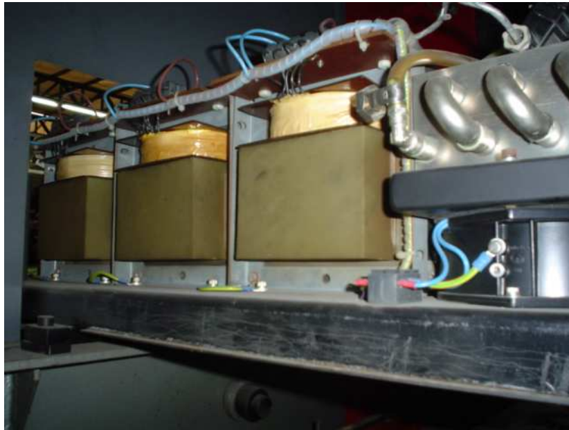
Figura 2.4 Transformadores de la máquina CNC EMCO Ls140.
