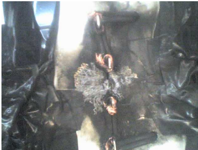
Figura 2.17 Tarjeta de estireno quemada debido a un arco eléctrico.
