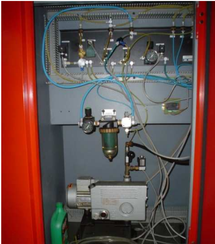
Figura 2.10 Conexiones de las mangueras, bomba de vacío, válvulas y filtro de la máquina CNC.
