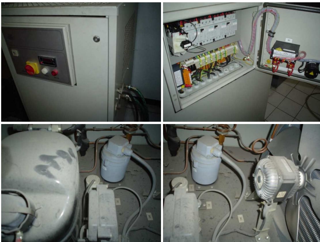
Figura 2.25 Módulo externo de enfriamiento, relevadores y tarjeta de control para el enfriamiento del agua.
