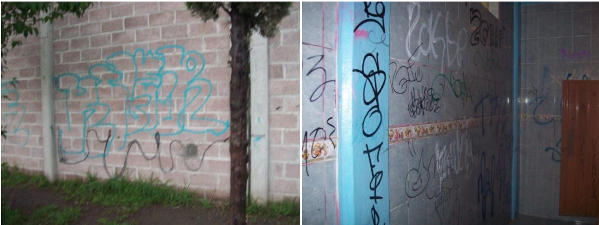
Tag y bombas al interior de la escuela secundaria.
