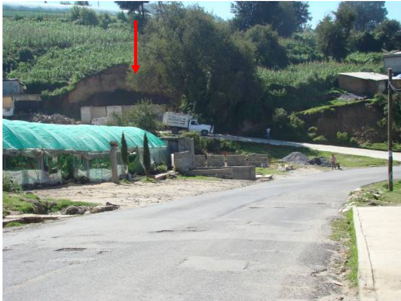
Figura 30. Corte para construir una casa, se nota un derrumbe de menor escala.
