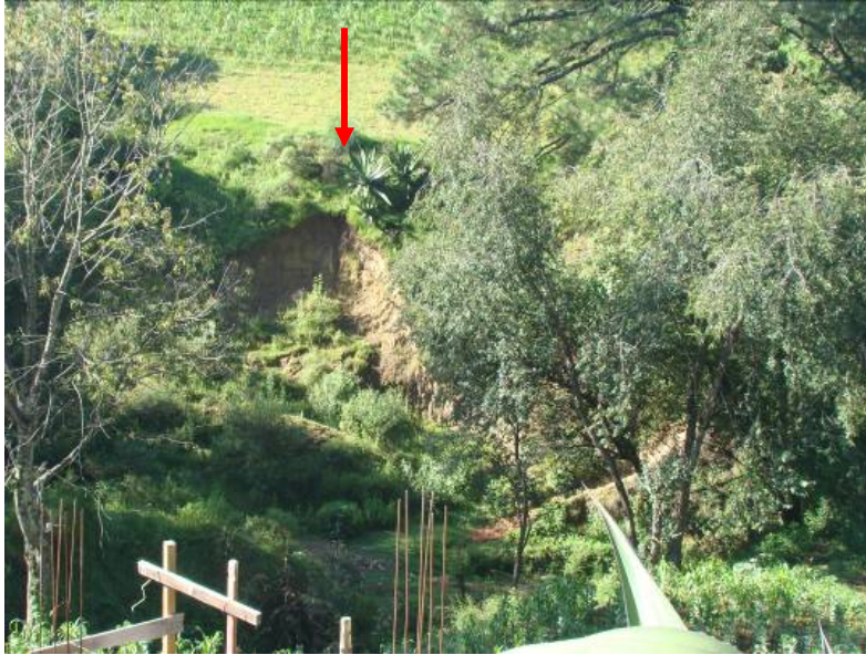
Figura 28. Ladera de barranco, en que se originó un derrumbe de pequeña escala.
