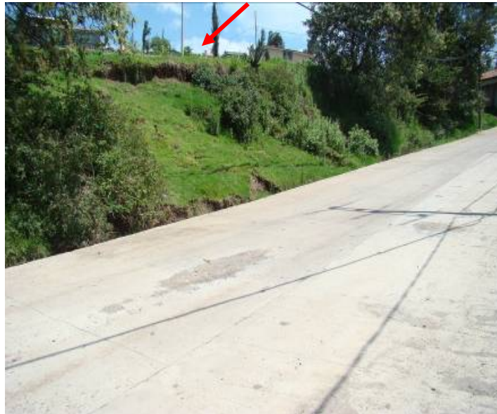
Figura 44. Corte de camino, la ladera presenta rasgos de un DSST.
