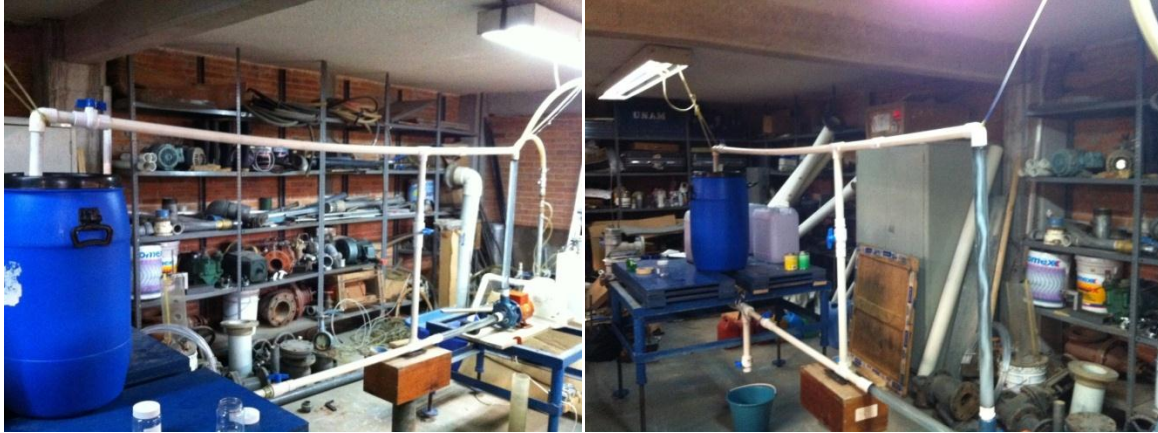
Figura 17. Diferentes ángulos de la implementación del rediseño para el circuito de la bomba ¼ HP, donde se muestra la cavitación tipo vórtice a la salida de la bomba.
