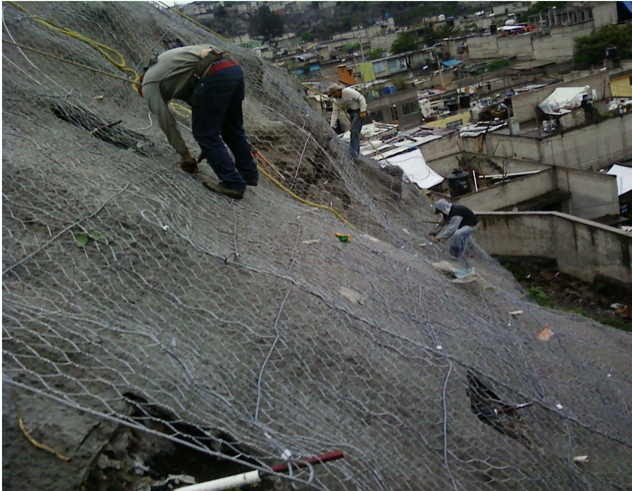
Figura 95. Colocación de malla triple torsión reforzada con cable de acero de \frac{5}{16} ” de diámetro.
