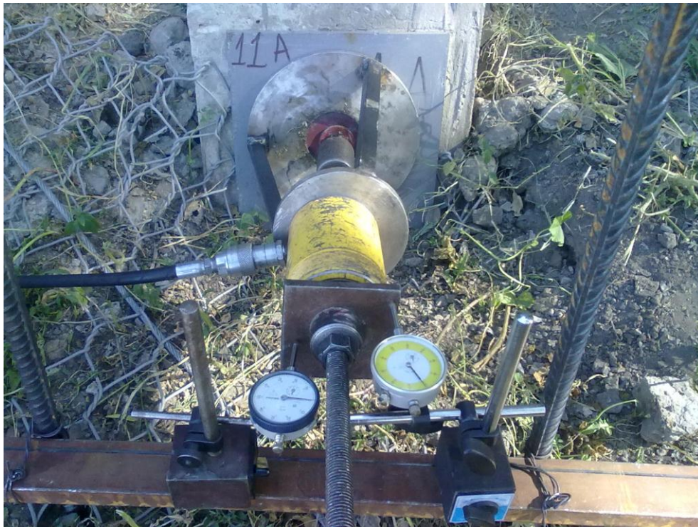
Figura 99. Equipo de tensado.
