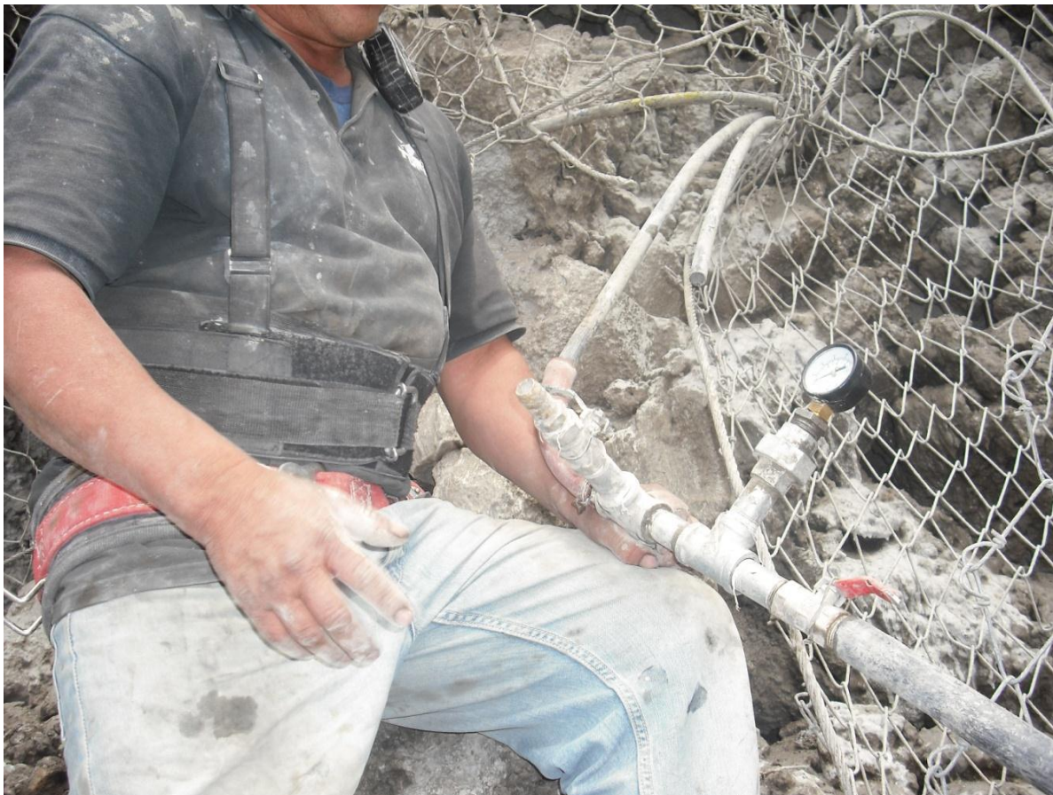
Figura 87. Inyección en barreno con manómetro en la entrada del mismo para garantizar la presión de proyecto.
