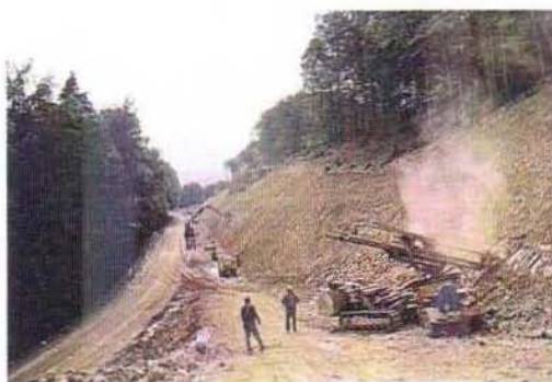
Ejemplo: Trabajos de perforación realizados empleando una máquina perforadora autopropulsada de cadenas.
