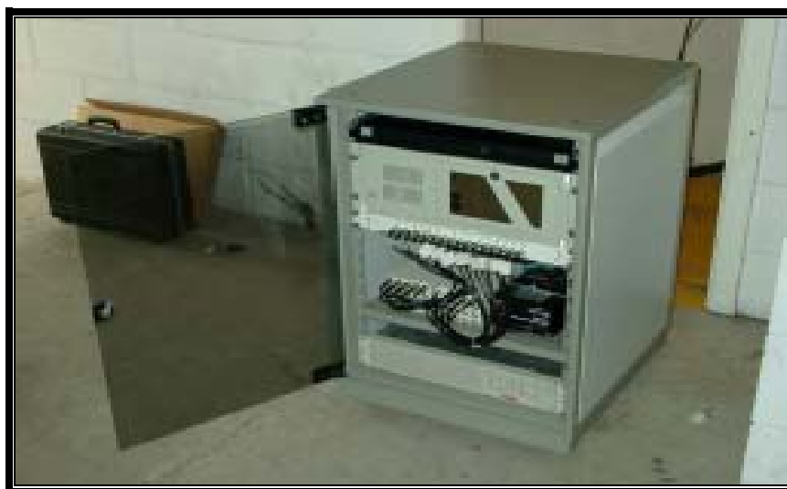
Figura 3.8. Gabinetes para centro de adquisición de datos.
