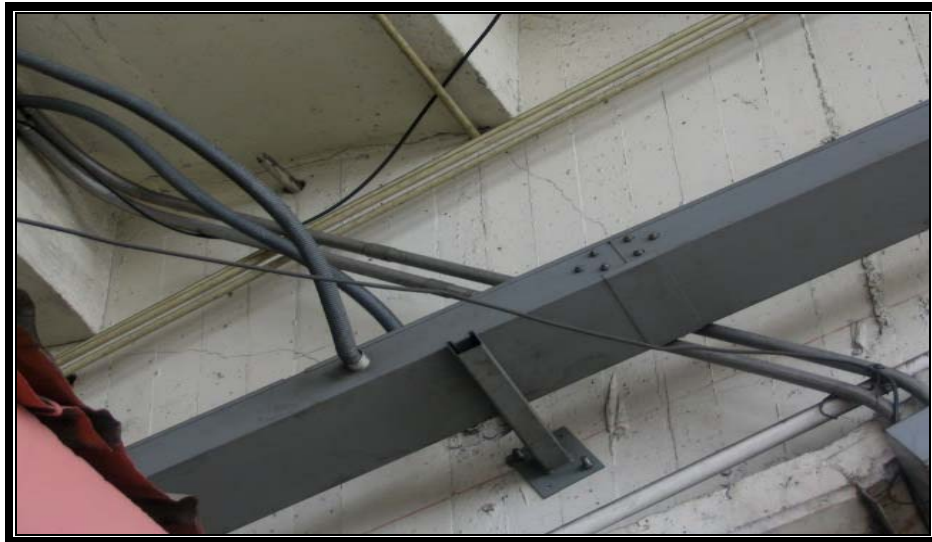
Fig. 1.4.3 Fisuras en la estructura principal del estadio Nemesio Camacho el campín.
