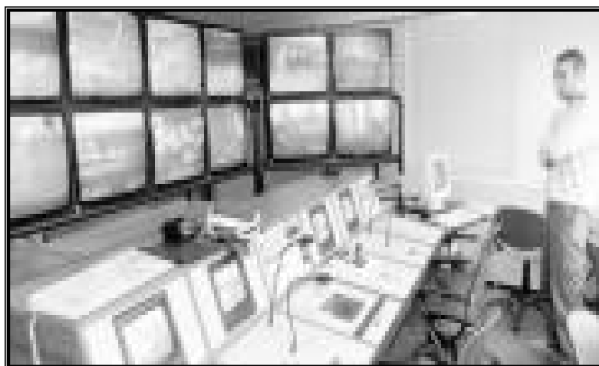
Figura 3.1. Unidad de control
