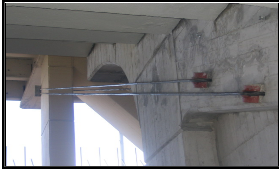
Figura 2.61. Cables de tensionamiento en tribuna oriental.
