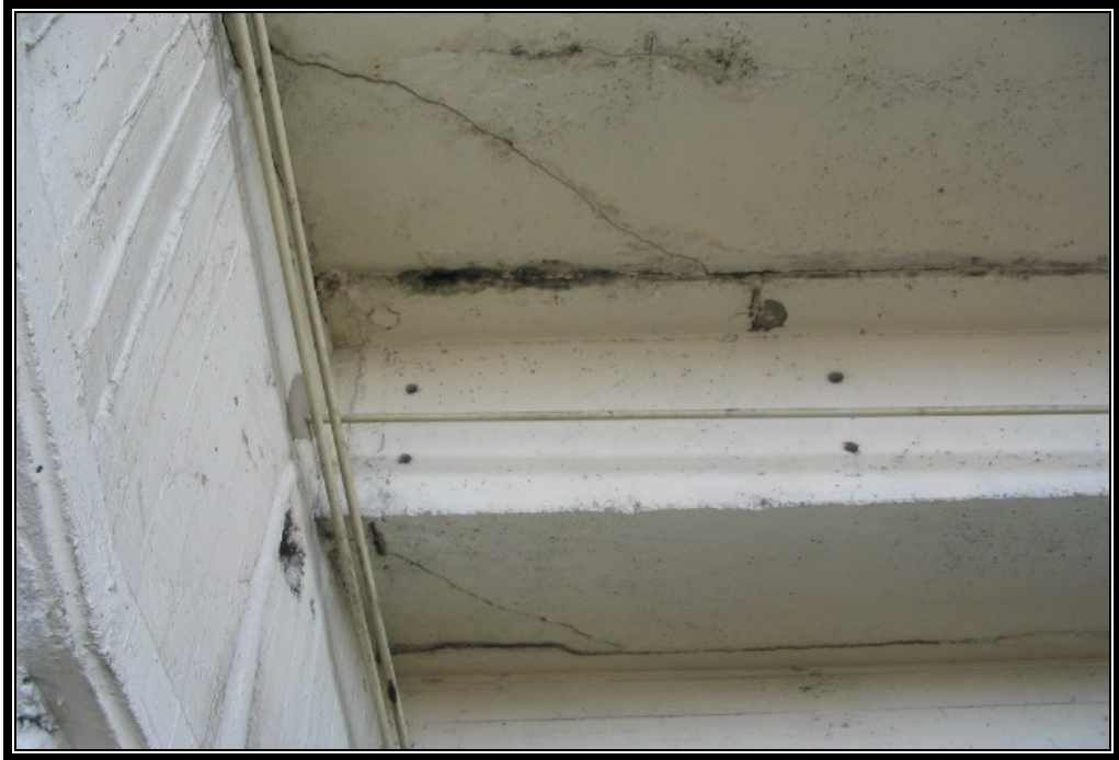
Figura 1.15. Fisuras diagonales en placas de tribunas.
