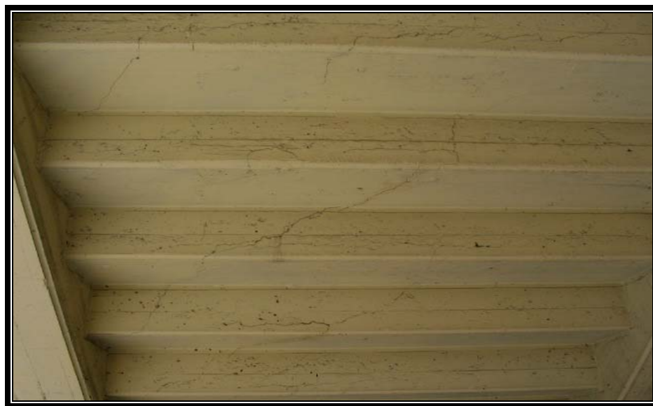
Figura 1.4.4 Fisuras en la estructuras de escaleras.
