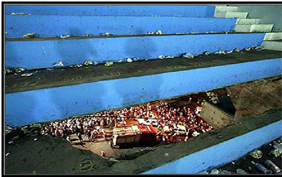
Fig. 1.4.1. Estructura rota en el estadio Fonte Nova.
