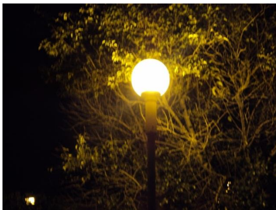
Fig. 75. Lámpara de vapor de sodio ubicada en el estacionamiento de la FES Acatlán.
