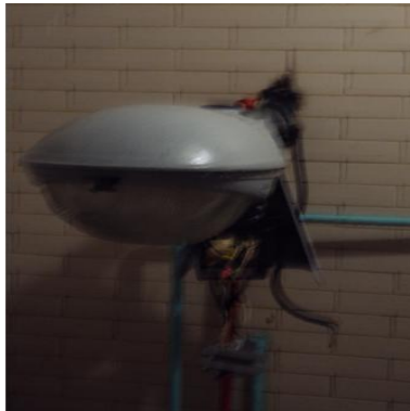
Figura 52. Luminaria lista para prueba de lluvia.
