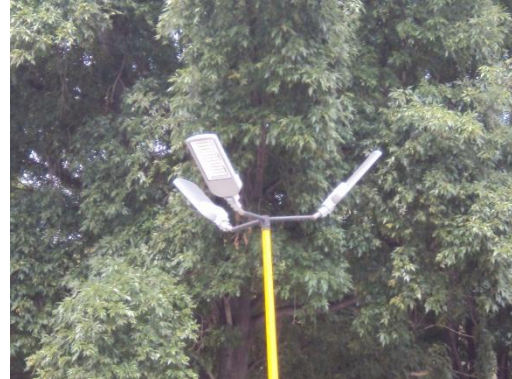
Fig.113 Acercamiento de las Nuevas Luminarias
