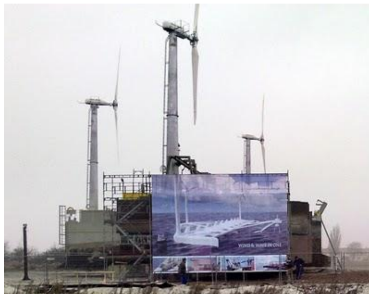
Figura 96. Generadores de Energía Eólica.
