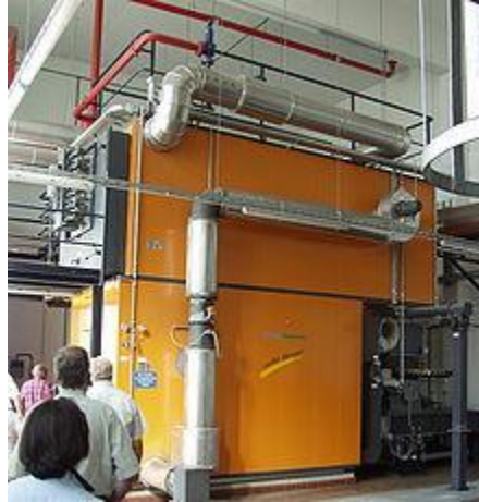
Figura 97. Caldera de combustión de biomasa en una central térmica de 2 MW en Lübeck, Alemania.
