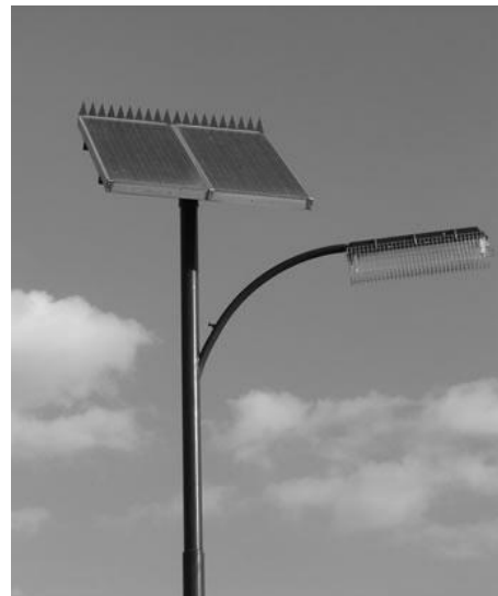
LUMINARIA SOLAR IMAGEN 106
