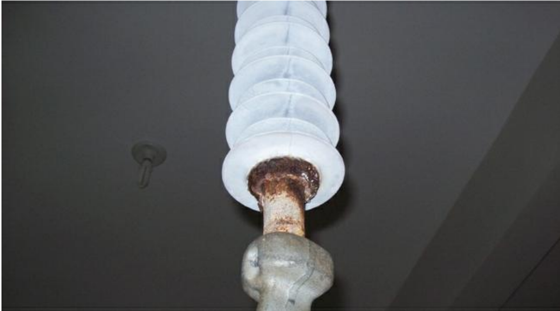
Acción de la corrosión
