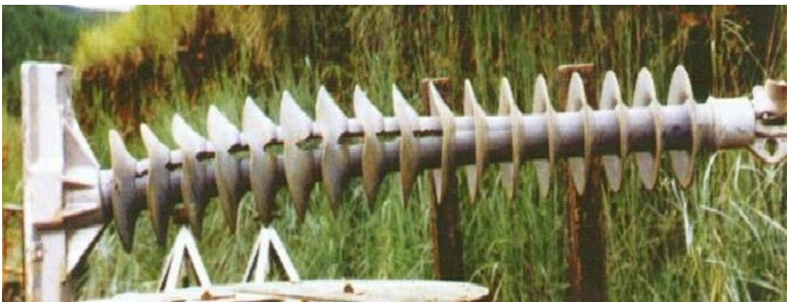
Destrucción del recubrimiento aislante por esfuerzos mecánicos
