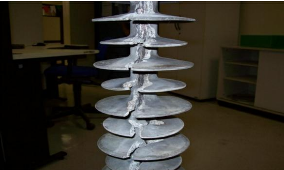
Arcos eléctricos sobre la superficie del aislador
