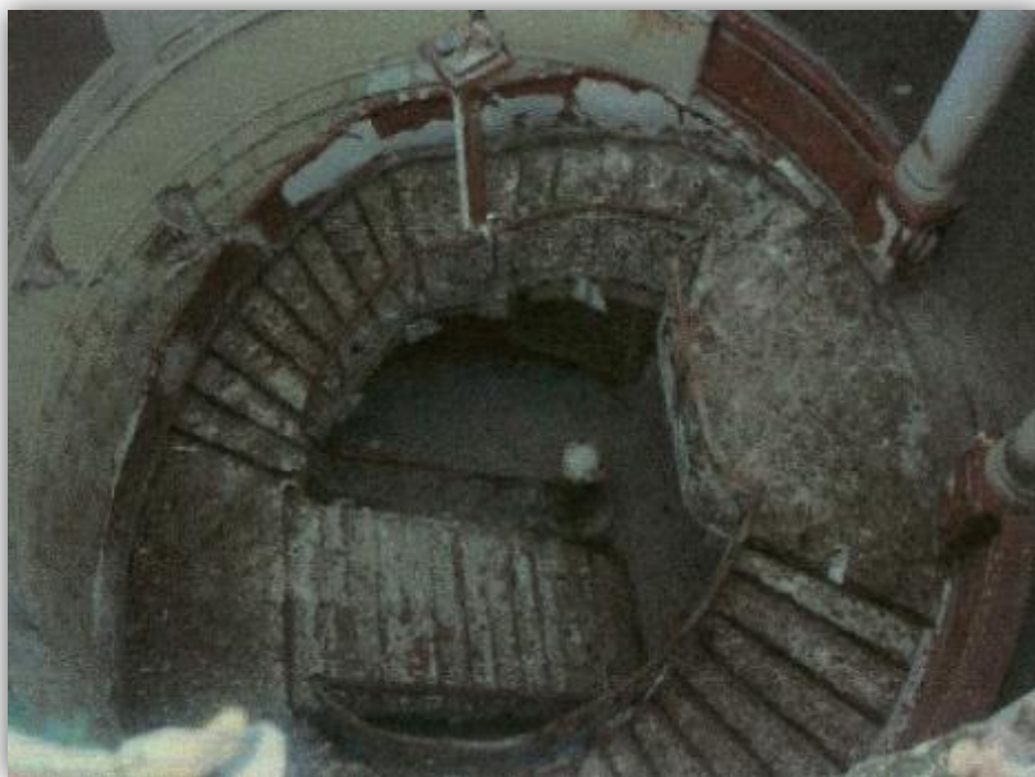
Figura 2.25. Daños en escalera del vestíbulo principal [2.16].
