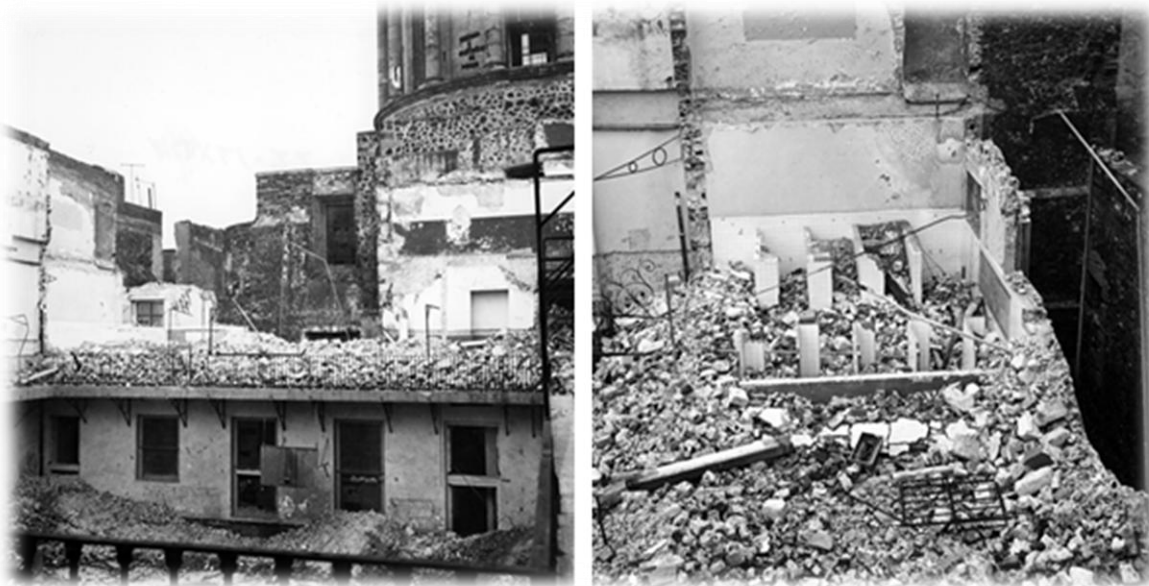
Figura 2.59. Derribo de muros en el Patio D, para realizar la excavación extensiva [2.15].
