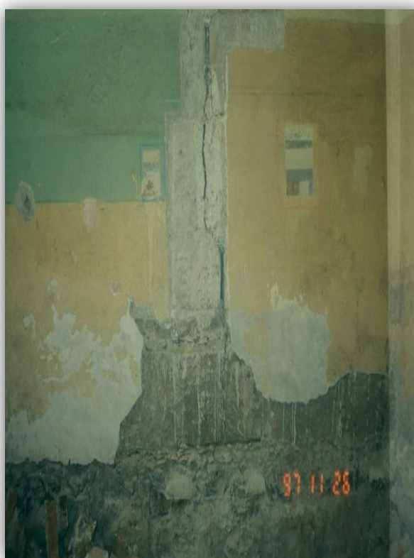
Figura 2.31. Grieta en muro, se puede apreciar cala sobre este para determinar pintura muros o azulejos [2.16].
