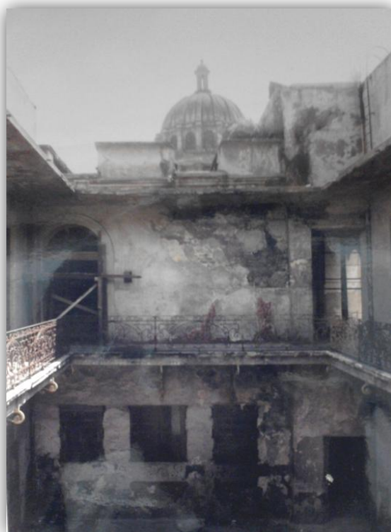
Figura 2. 28. Estado de la fachada del Patio B [2.16].
