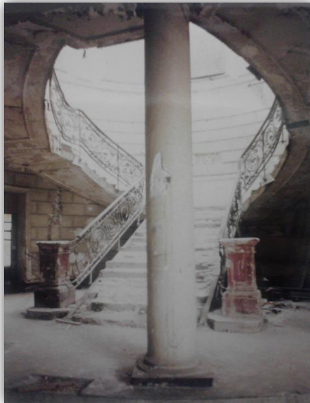
Figura 2.24. Entrada al vestíbulo principal, muestra daños en columnas y escalera [2.16].
