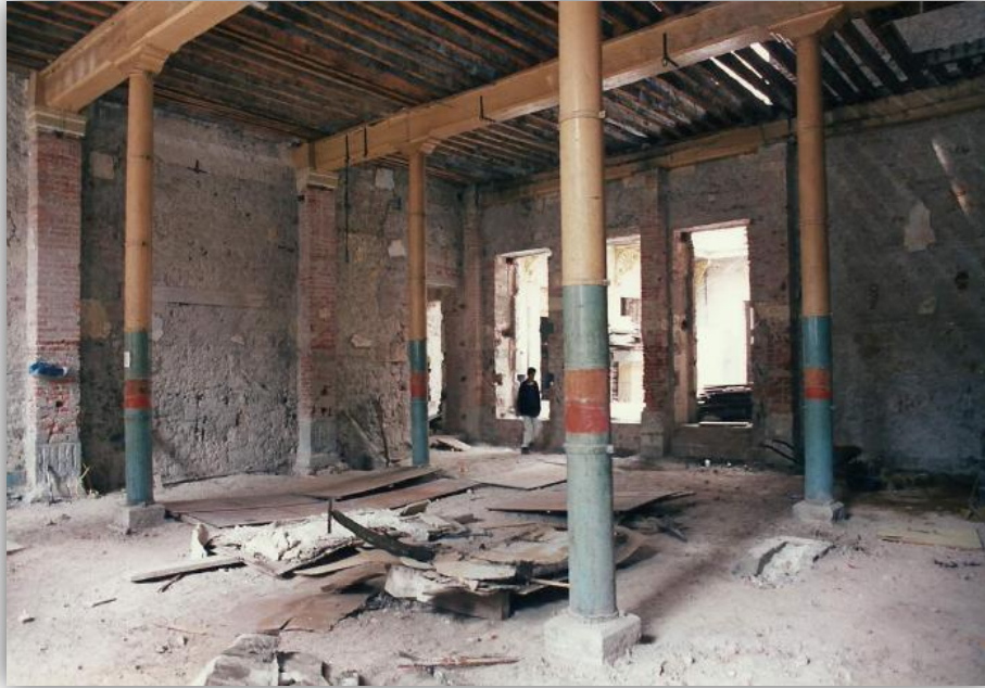
Figura 2.56. Local 16 antes de las excavaciones, se observan las columnas que existen desde la Escuela Normal para Profesores [2.16].
