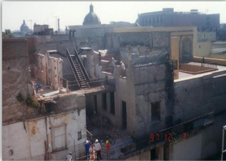
Figura 2.60. Estado del edificio anexo al comienzo de la restauración [2.16].
