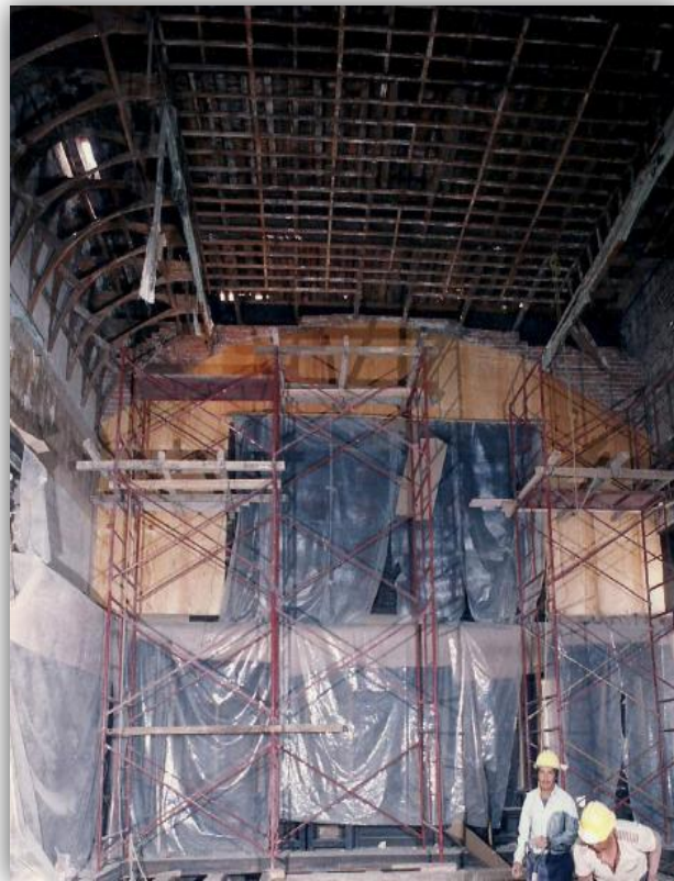
Figura 2.51. Tapiado del muro frontal del paraninfo, puede observarse el deterioro del plafón ecléctico [2.16].
