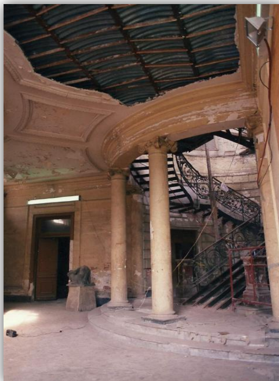
Figura 2.27. Oxidación de la vigería del entrepiso en la zona del vestíbulo principal [2.16].
