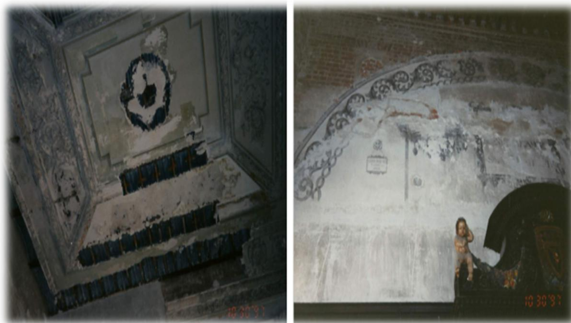
Figura 2.23. Deterioro del plafón eclético y de la pintura decorativa del Paraninfo [2.16].
