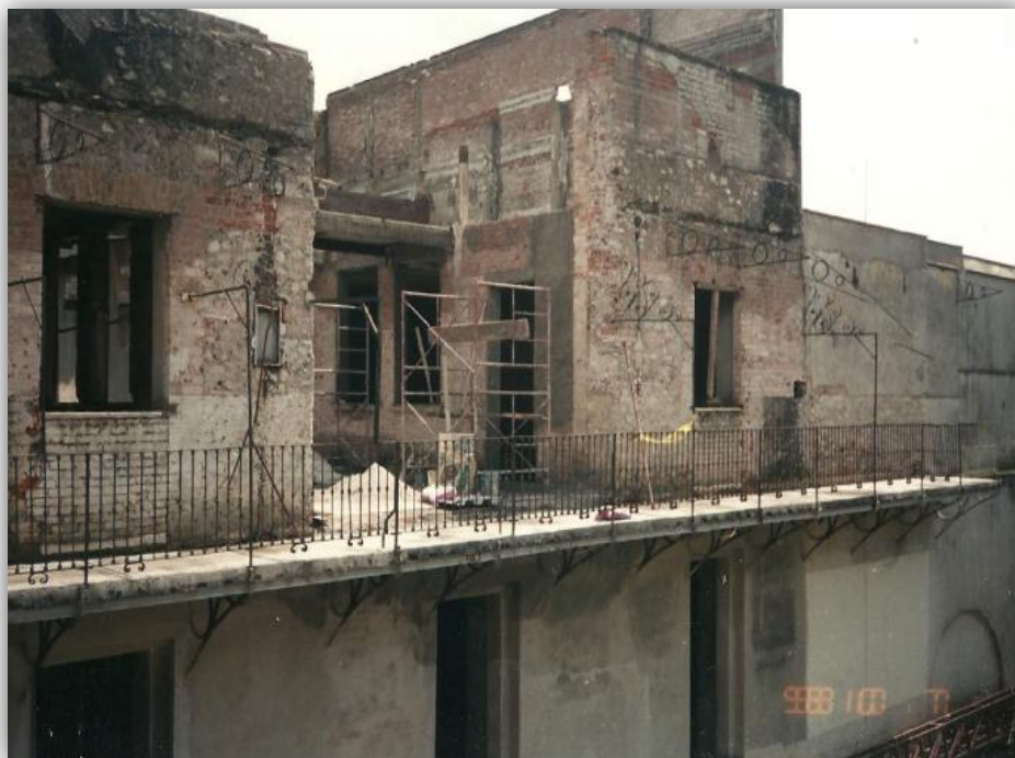
Figura 2.30. Deterioro del edificio anexo [2.16].
