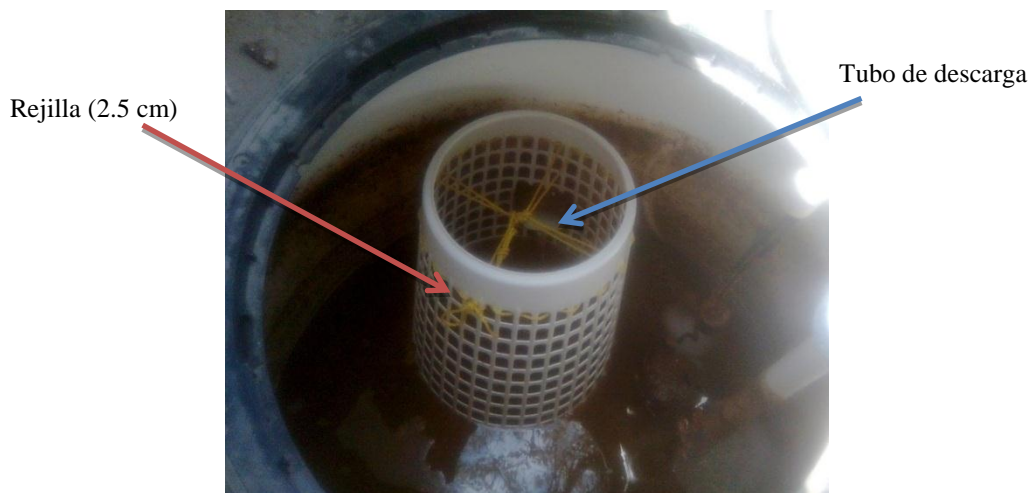
Figura IV-4. Rejilla del cárcamo de bombeo
