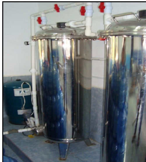
Fig. 9 Filtros de Arena
