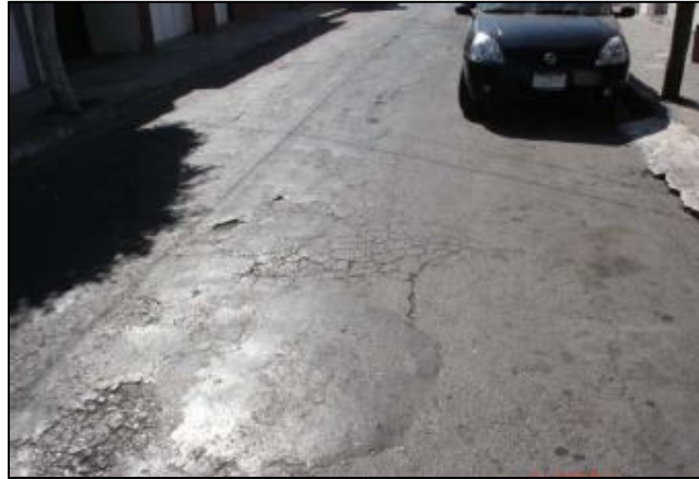
Fig. 2 Falla por exceso de asfalto en riego de liga [4]
