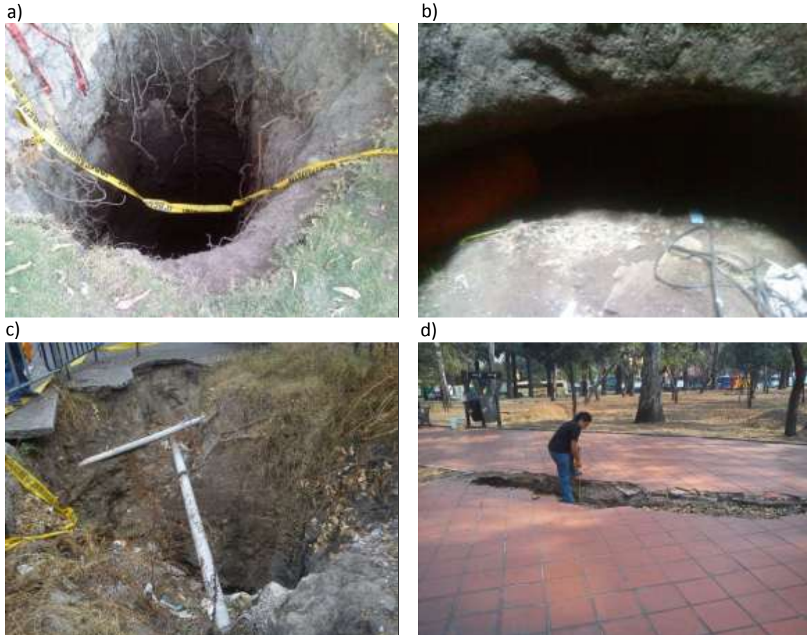
Figura 2. a) Hundimiento ubicado frente a la zona recreativa “El Sope”. b) Interior de la oquedad presentado en a). c) Hundimiento en el área verde situada en Av. de los Compositores cerca de la fuente de Xochipilli. d) Grietas que aparecieron recientemente, situadas entre la feria de Chapultepec y el lago Mayor sobre Av. de los Compositores
