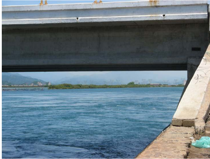
Figura II-8 Canal de Llamada
