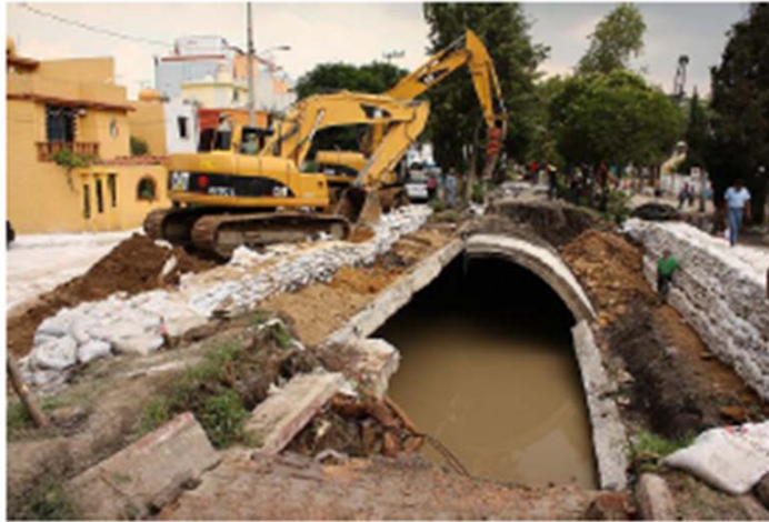
Figura 4.1. Ruptura del Túnel Emisor Poniente Ciudad de México en el 2009
