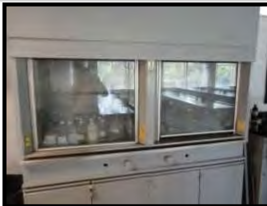
Foto 8. Campana de extracción.
