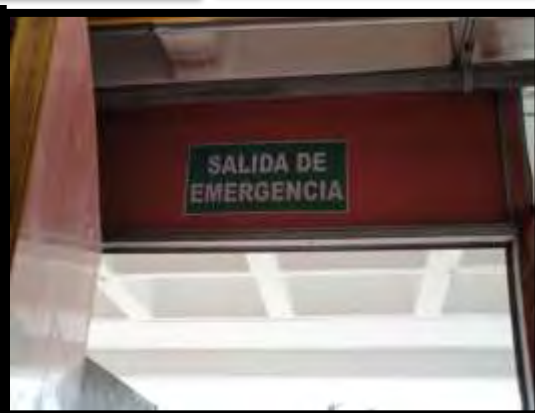
Foto 9. Señalamiento de ubicación de la salida de emergencia.
