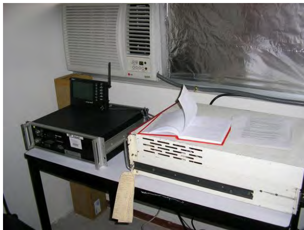
Figura 4.15. Interior del sitio de monitoreo en el CECATI 55.
