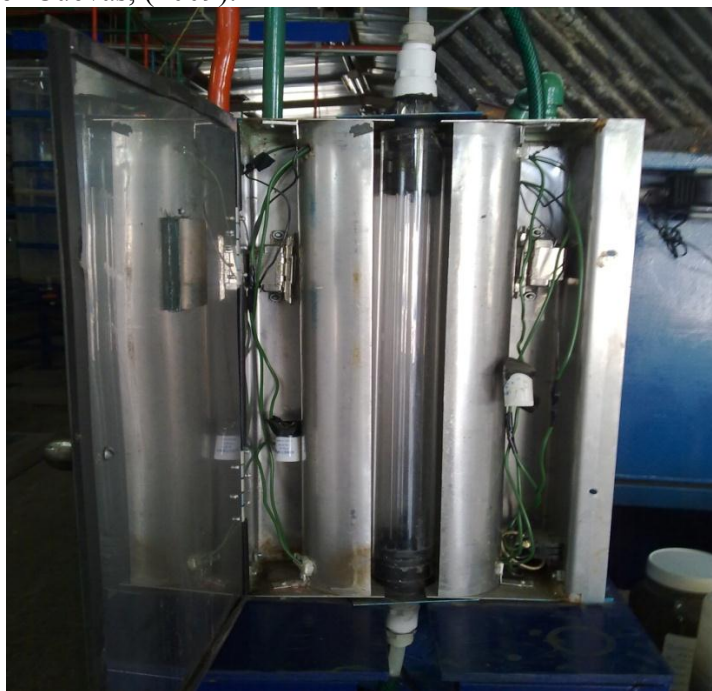
Figura 2.14. Fotoreactor de radiación ultravioleta.
