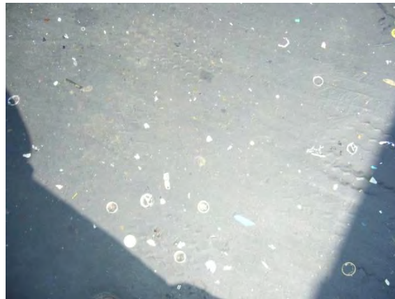
Foto 52: Carpeta asfáltica sin pintar, cruce de Vidal Alcocer y Eje 1 Norte, 5 de enero de 2010. (Foto: CC).
