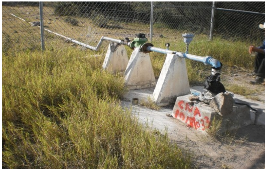
Figura 8b. Censo de aprovechamientos Pozo 1013-33
