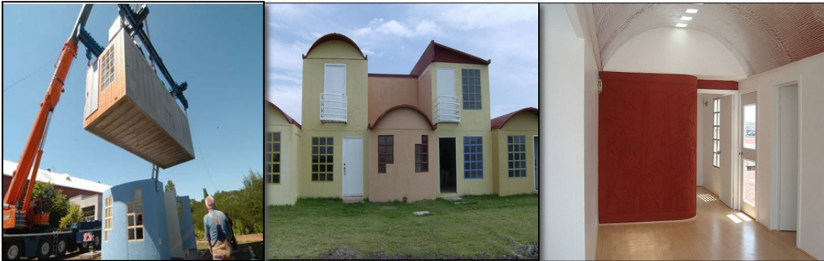
Ilustración 75. Montaje de un módulo de concreto (izq), Vista exterior de la vivienda con este sistema (centro), Vista interior de la vivienda (der) 141
