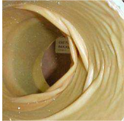
Fig. 8 Pobre ajuste en la tubería.
