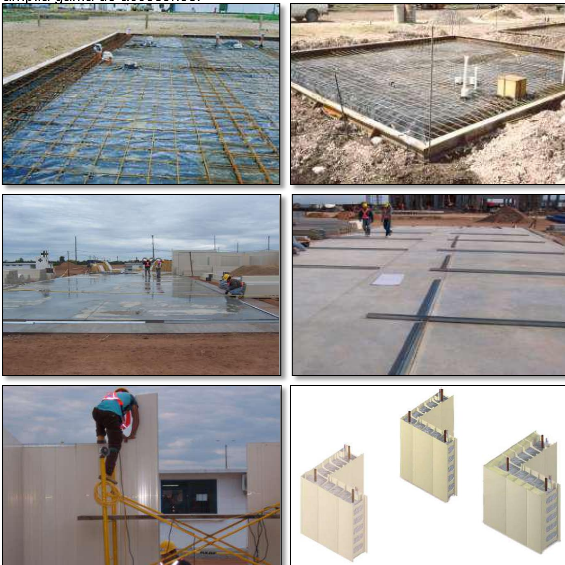
FOTOGRAFIA 7 a), b), c), d), e) y f) Distintas etapas en el proceso de cimentación
