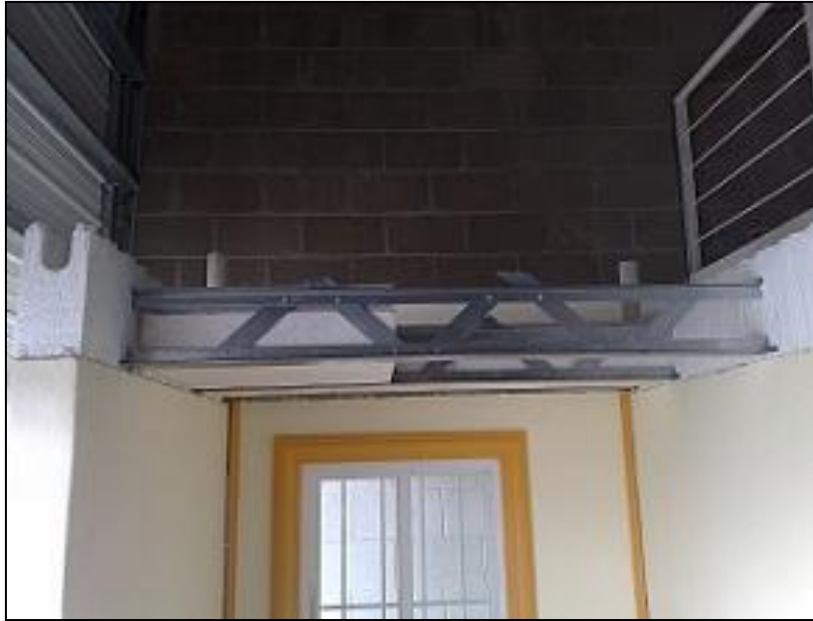
FOTOGRAFÍA 6. Techo con el sistema RST
