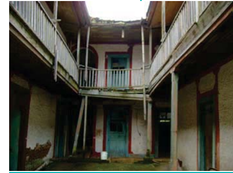
Figura 121. Vista del patio del hotel, se observa pérdida de aplanado en los muros así como presencia de micro-flora parásita en la parte inferior de los muros a causada por absorción producto de encharcamientos. Pérdida de elementos como columnas y puertas. Presencia de hongos cromógenos en elementos de madera.
