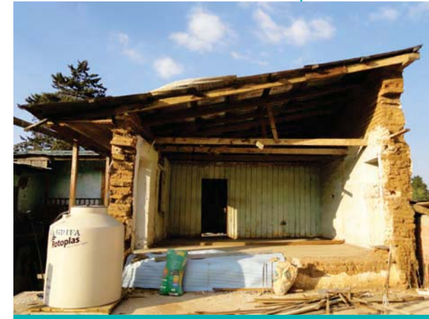
Figura 115. Restos de las habitaciones del patio trasero del "Hotel Palacio de Cristal". Como se puede ver en la imagen este tipo de inmuebles se edificaron empleando el mismo sistema constructivo, materiales y tipología arquitectónica
