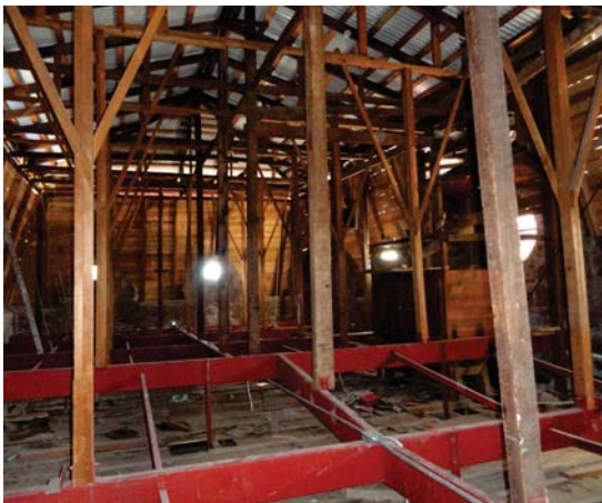
Figura 45. Estructura de la mansarda del palacio municipal de “El Oro”. Foto: N. Tepox, 2011.
