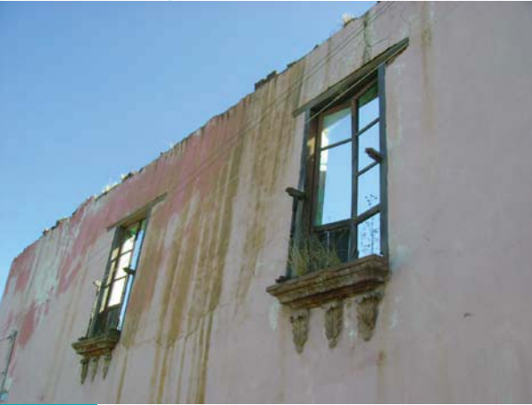
Figura 93. Restos de un inmueble del centro de población. Desafortunadamente existen en el centro histórico de "El Oro" muchos inmuebles particulares en el mismo estado que solo conservan la fachada. Foto: N. Tepox P. 2011.
