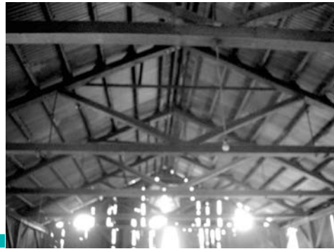
Figura 44. Armaduras de madera de La Casa Roja. Oficinas de “El Oro Mining & Railway Co.”. El sistema constructivo empleado determinó las características espaciales y tipologías de estos edificios. Foto: N. Tepox, 2010
