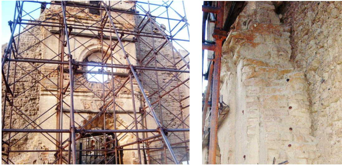
Fotografías de la Iglesias de Cocóspera, de fábrica jesuita pero modificada por los franciscanos. Se observa la sobreposición de la fachada franciscana de ladrillo a la de adobe de fábrica jesuita (Fotografía del autor, marzo de 2012).
