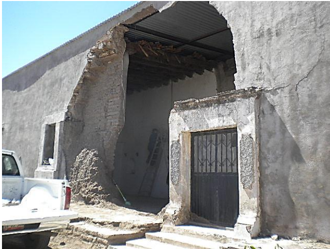
En la iglesia de la misión de Ónavas localizada en la Pimería Baja se observan actualmente deterioros irreversibles y alteraciones a la fábrica de la iglesia (Fotografía Centro INAH Sonora, Ónavas, noviembre de 2011)
