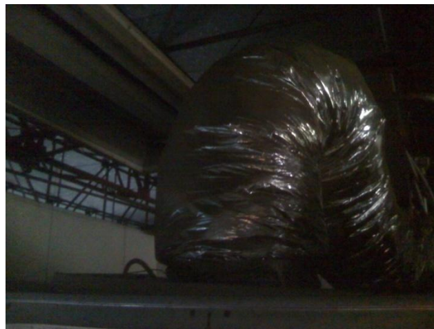
Fig.4.9 Ducto circular con aislamiento.
