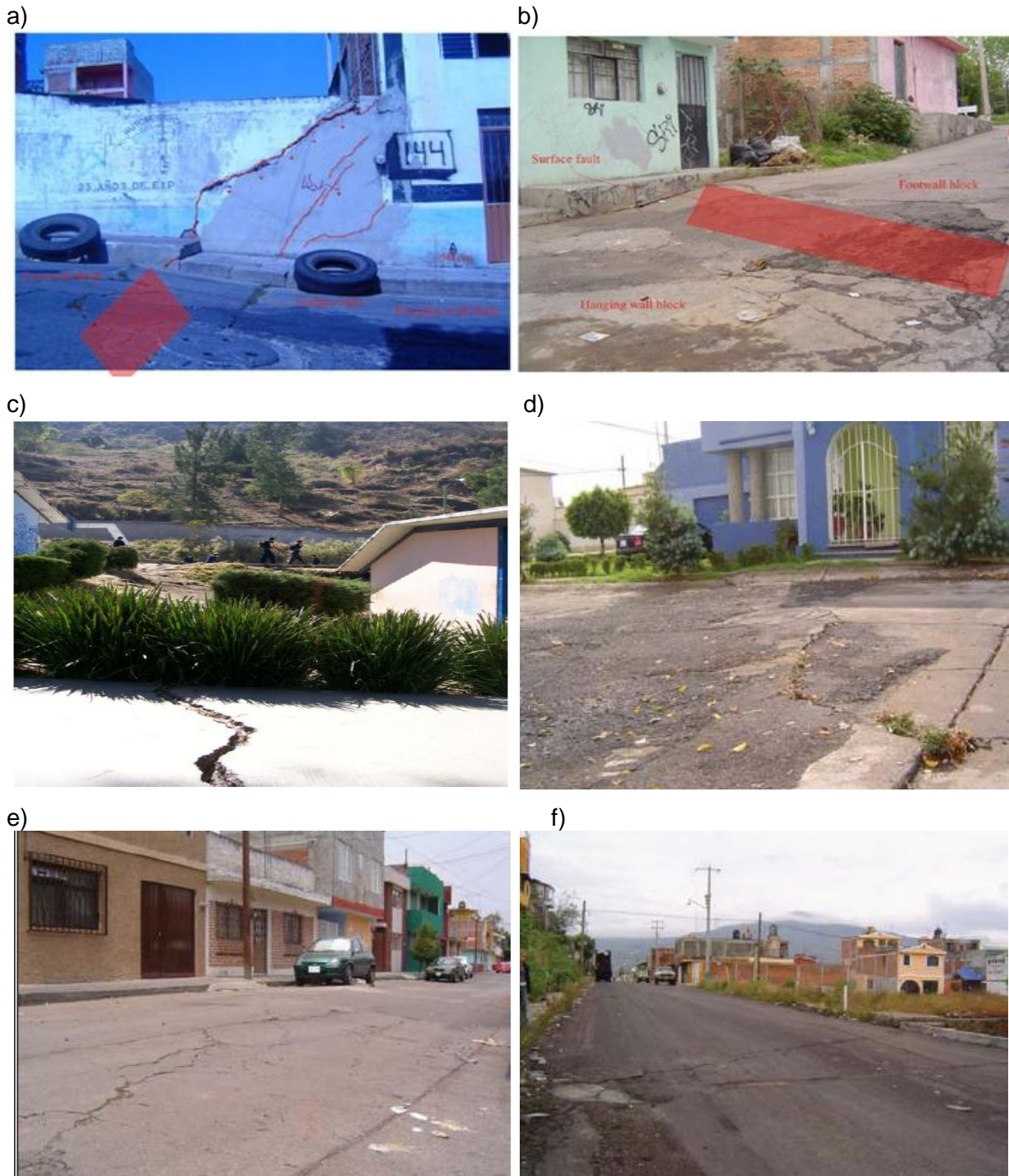
Figura 1.1. Efectos y daños ocasionados por las fallas en la zona urbana de Morelia. a) Falla Central Camionera; b) La Colina. Rectángulo rojo indica el plano de falla, líneas rojas indican fracturas (Tomadas de Ávila-Olivera y Garduño-Monroy, 2008); c) La Paloma (Tomada de Echeverría et al., 2008); d) Falla Torremolinos; e) Falla Cuautla y F) Falla El Realito (Tomadas de Ávila-Olivera, 2008).
