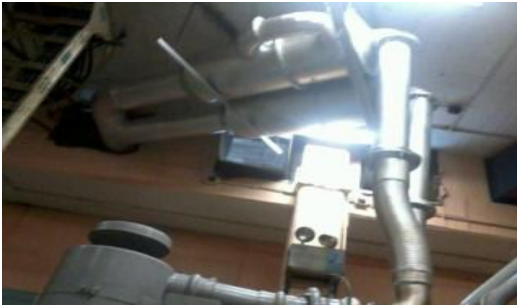
Figura 2.29 Silenciador y escape de planta de 400KW
