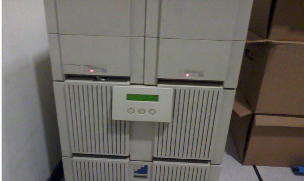
Figura 3.24 UPS Stand By de 5 KVA de la marca MATRIX 5000
