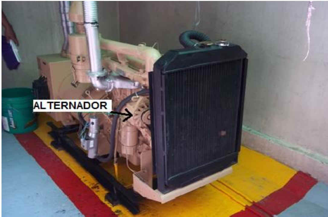
Figura 2.13 Localización del alternador en planta de emergencia.
