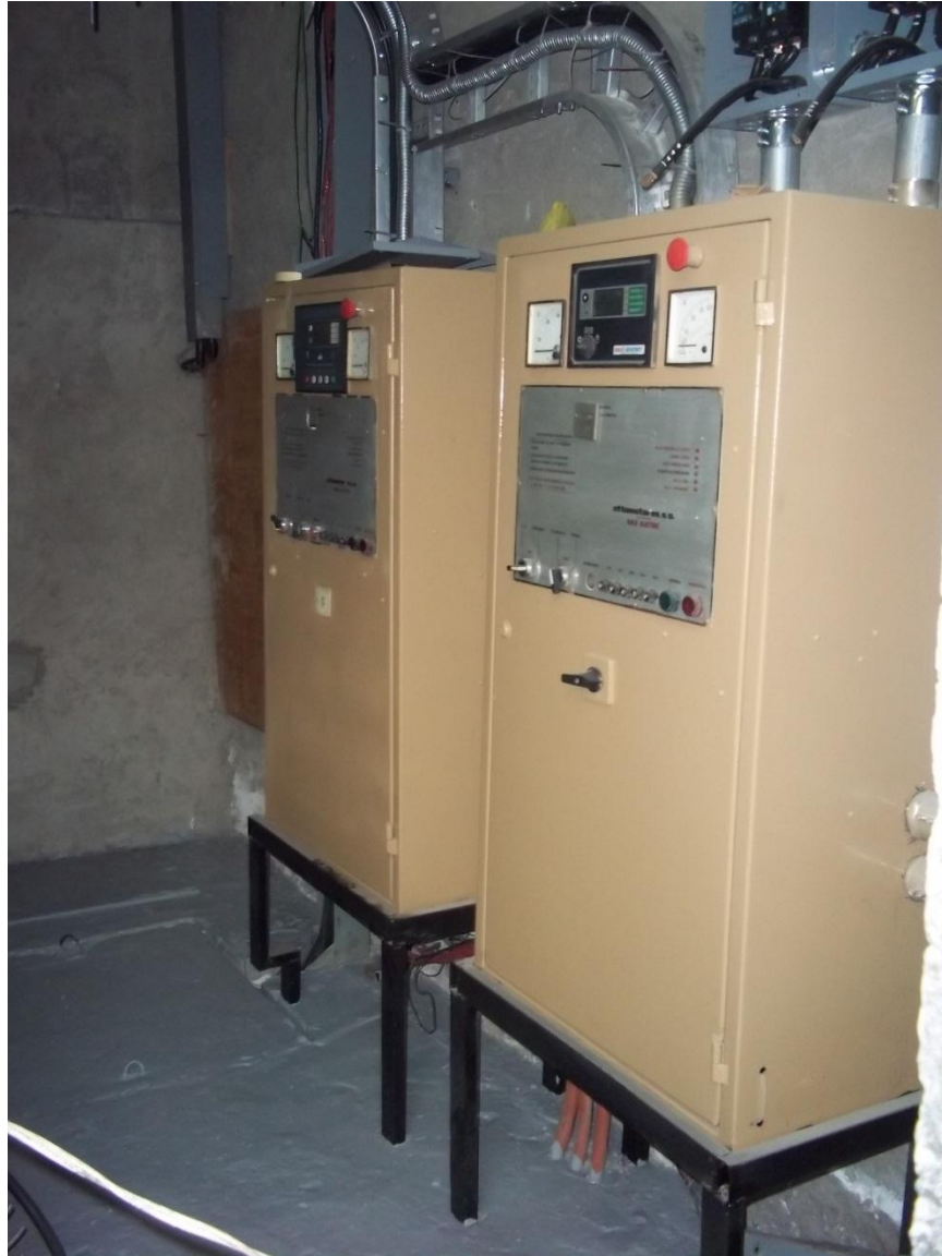
Figura 2.16 Gabinetes de transferencia
