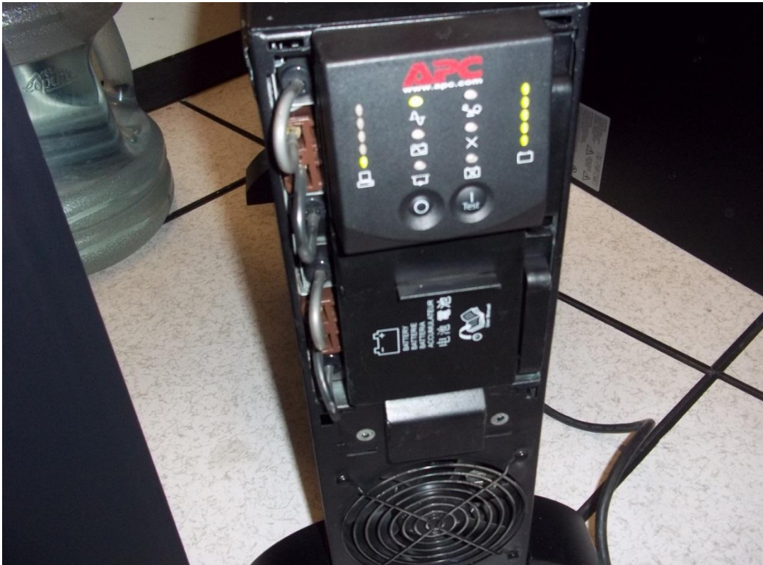
Figura 3.25 UPS INTERACTIVA marca APC de 3 KVA
