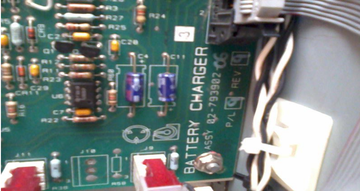
Figura 3.13 b) Acercamiento del circuito cargador de baterías
