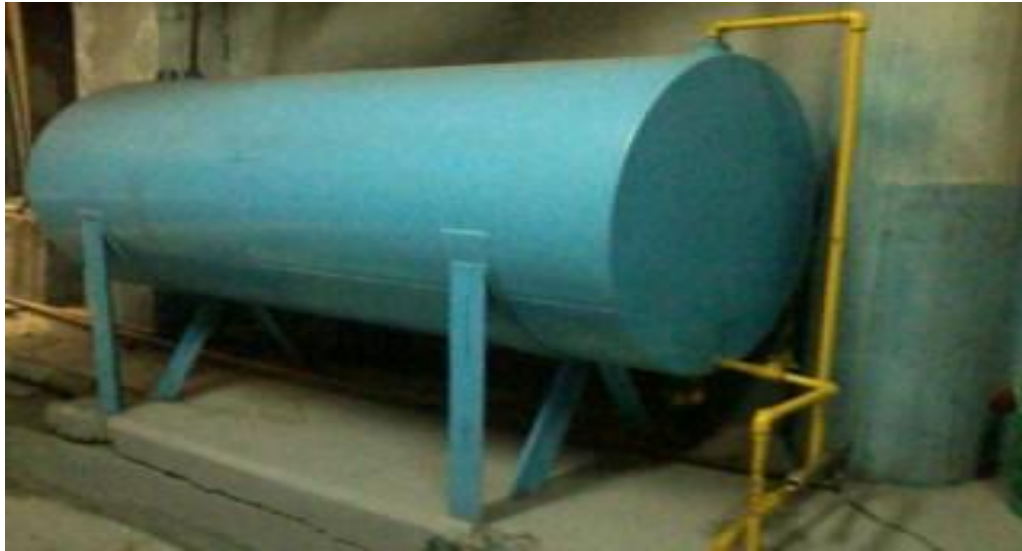
Figura 2.4 Tanque de almacenamiento para Diesel
