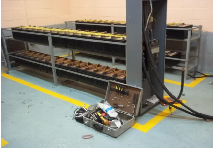
Figura 3.10 Figura Banco de baterías
