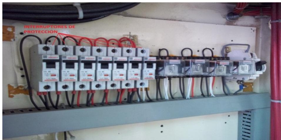
Figura 2.22 Interruptores termo magnéticos de protección.
