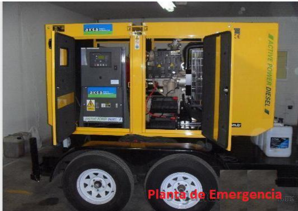
Figura. 2.3 Planta de emergencia móvil de 30KW con caseta acústica
