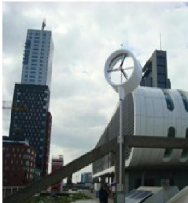
Capítulo 3 Imagen 17 DonQi instalado sobre muro
