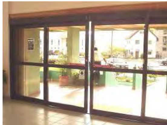
Figura 1.3.6, puerta con sensores para operación automatizada.
