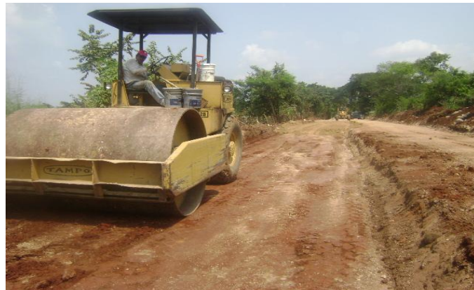
IMAGEN 4-B. Vibro-compactador utilizado para alcanzar la compactación del proyecto. Fuente: Foto tomada en obra
