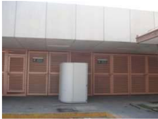
Cuarto de Maquinas
