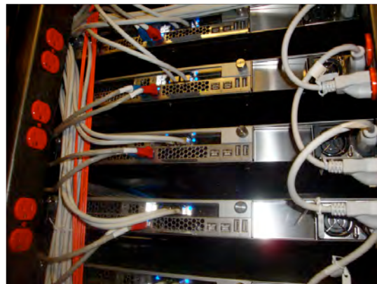
Figura 5-2. Vista trasera de los servidores Xserve, se puede observar las dos conexiones de red que van a ser utilizadas así como las conexiones de tarjeta de fibra óptica necesarias para operar dentro del flujo del sistema tapeless.
