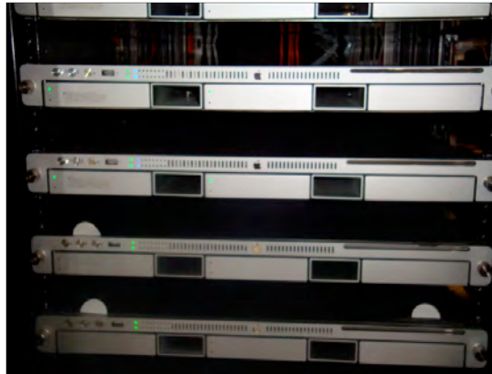
Figura 5-1. Servidores Xserve vista frontal.
