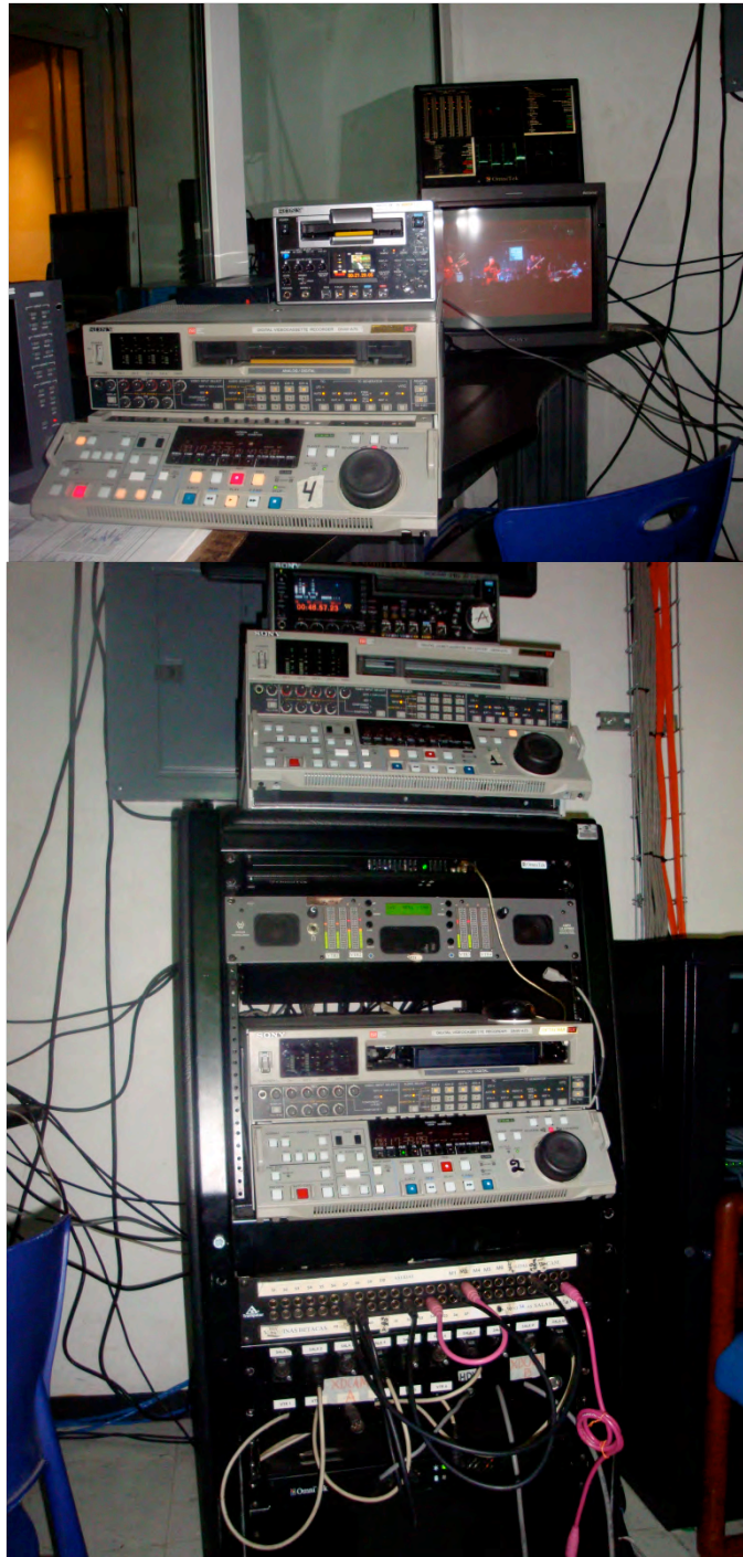
Figura 3-23. En las fotos se observan las máquinas reproductoras de los formatos SX (3), Mini HDV (1) y XDCAM(1), así como la tira de parcheo y los monitores tanto de imagen como los monitoreos de normas que se realizan con los rasterizadores.
