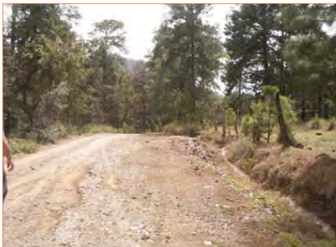
Foto 6.6: se observa que corre agua al lado del camino por una zanja.
