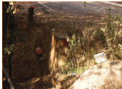
Foto 6.7: aquí vemos una obra de drenaje inservible.
