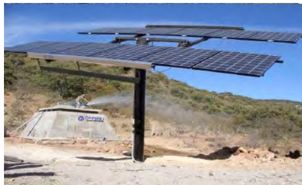
Figura 4.2. Paneles Fotovoltaicos en Campo
