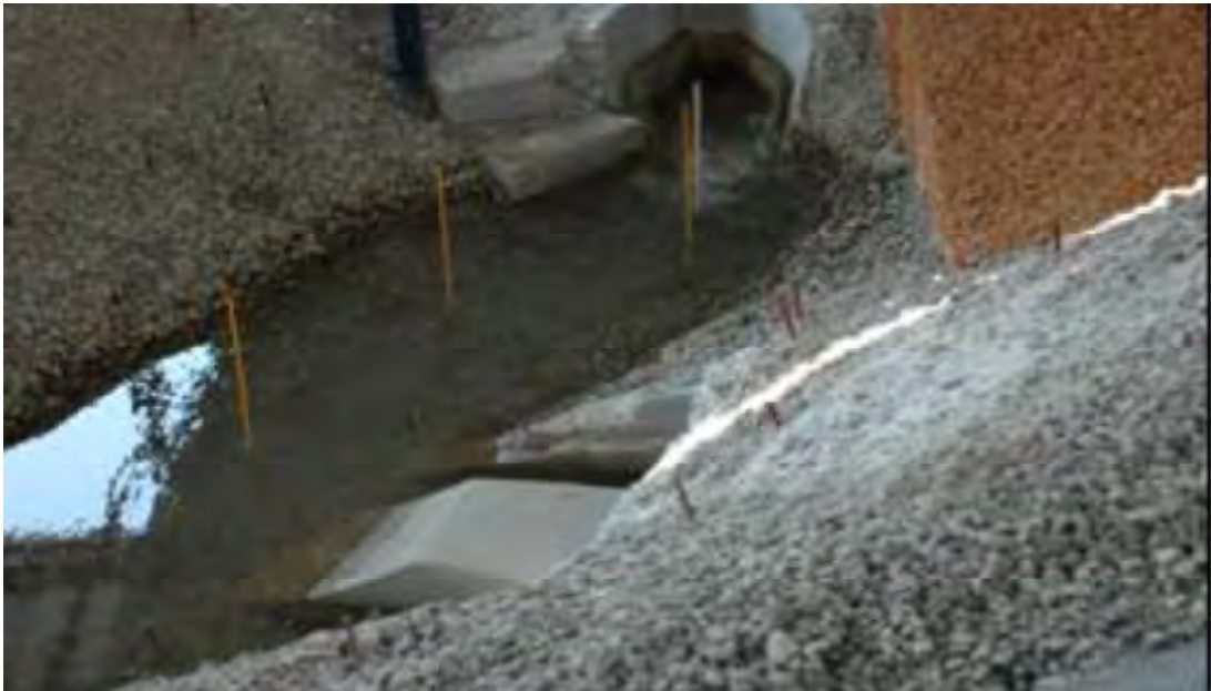
Figura 5.27 Nivel de agua en el desfogue de generación, elevación 397.15 msnm (Laboratorio de Hidráulica, CFE, 2007)
