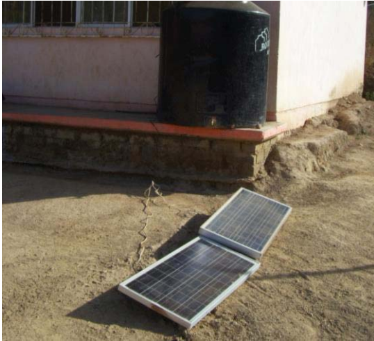
Celdas solares , para escuela primaria en comunidad huichol. Electrifica un foco y una computadora. Es el único edificio en la comunidad con energía eléctrica. Huaynamota, Nayarit. Foto: Vanaquen Navarro
