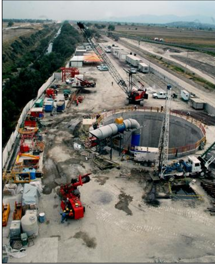
Figura 2.- Aspecto aéreo de una lumbra de servicio sobre el trazo del TEO.
