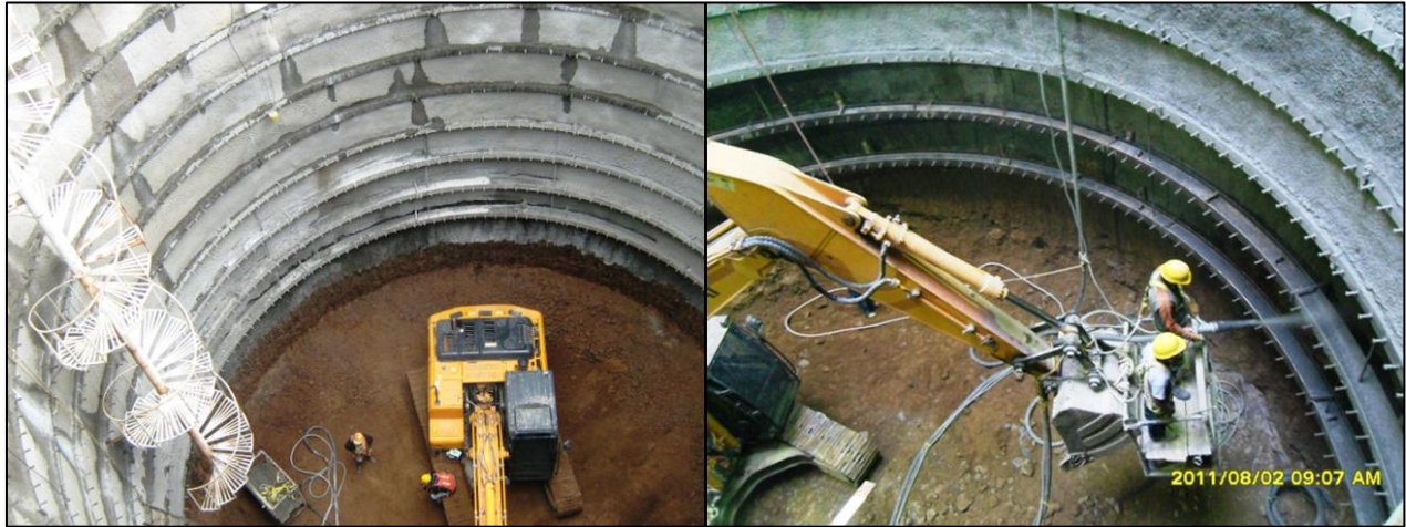
Figura 3.- En la foto de la izquierda se muestra un revestimiento primario hecho a base de concreto lanzado y perfiles metálicos, también se aprecia la excavación del núcleo con retroexcavadora. En la fotografía de la derecha se muestra el lanzado de concreto. En ambas fotografías, se aprecian los conectores por cortante en los perfiles metálicos debido a que para el caso específico de esta lumbrera (L23-A) se colocará un segundo revestimiento de concreto reforzado convencional.
