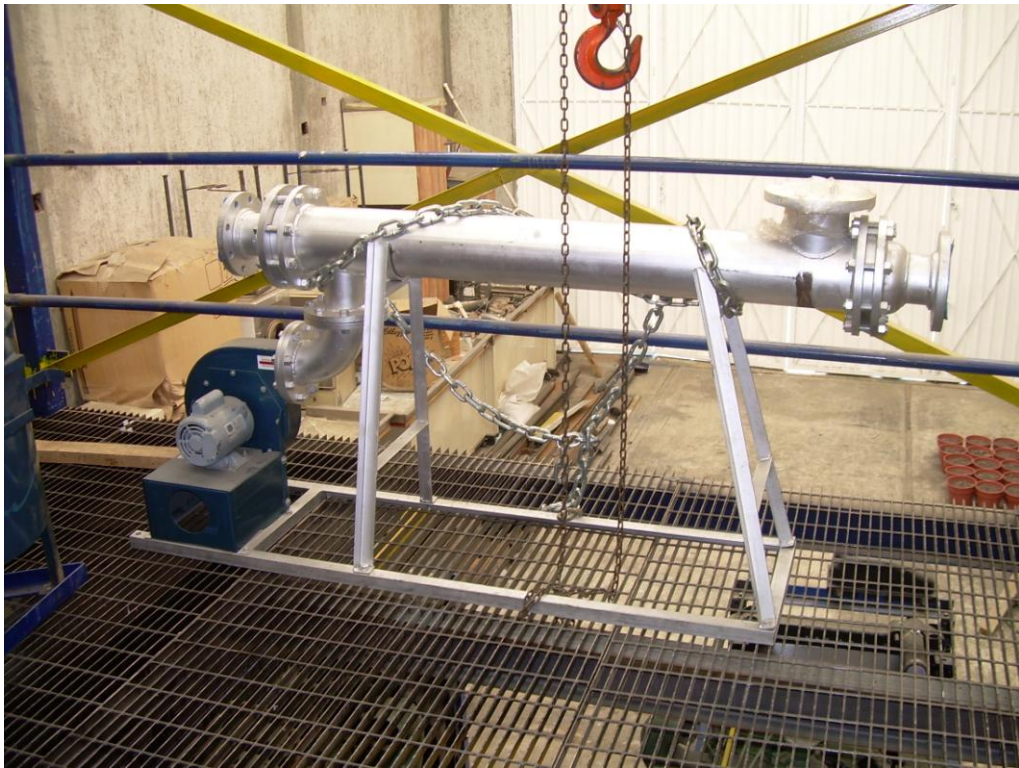
Figura 2-6: Vista lateral 1 del intercambiador de calor (elaboración propia).
