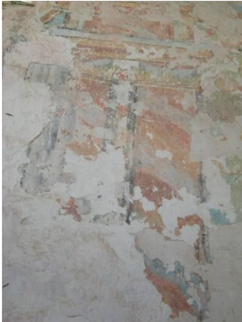
44. Detalle donde se aprecian las columnas que tal vez imitan el mármol veteado, en la parte superior se puede apreciar la estructura rectangular que corona a las columnas y que tiene perspectiva, retablo, muro 3 del ábside de la iglesia, convento de Santa Clara de Asís, Dzidzantún, Yucatán, septiembre, 2009
