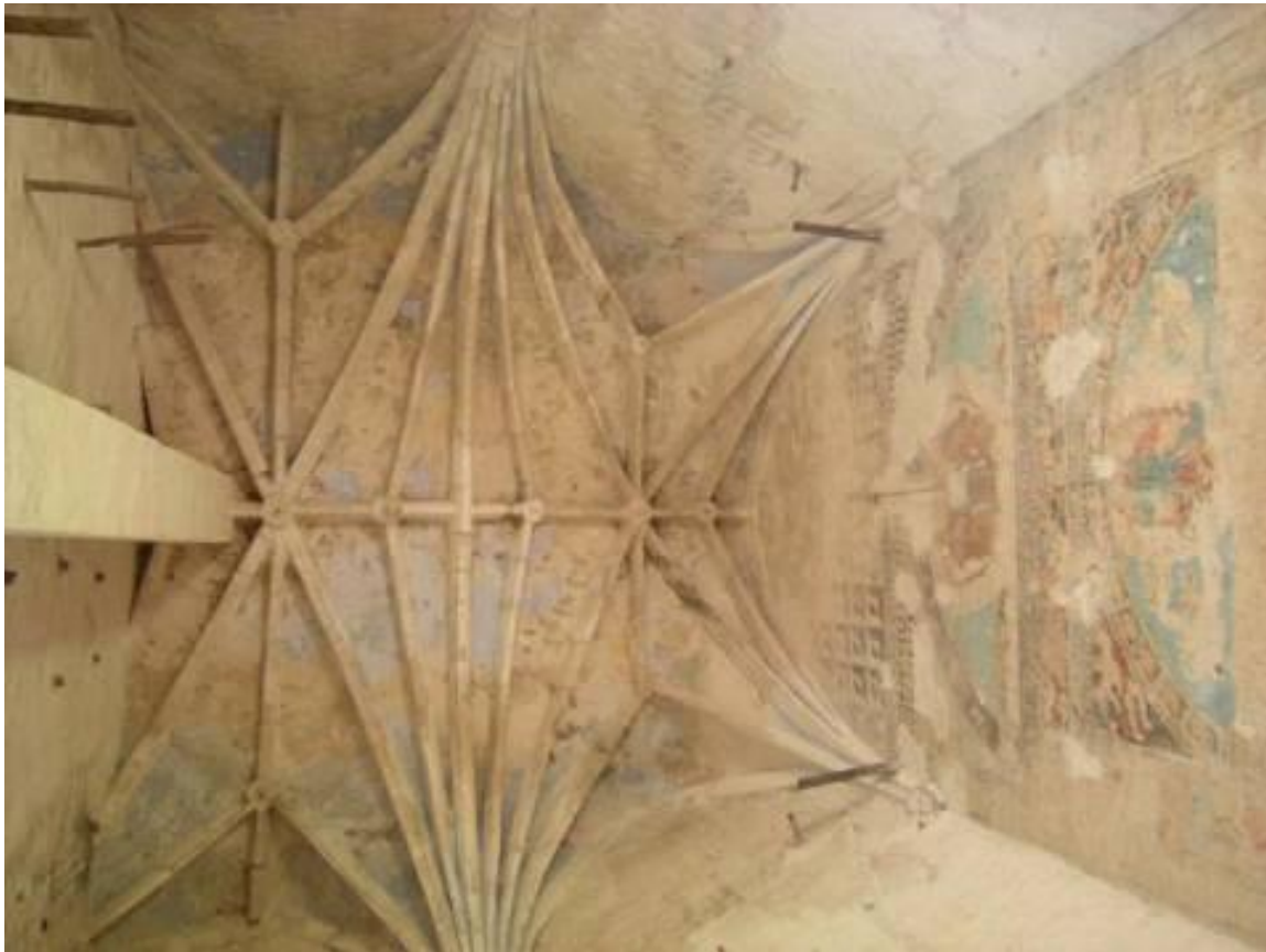
7. Interior de la sacristía de la iglesia del convento de Santa Clara de Asís, Dzidzantún, Yucatán, noviembre, 2008. A la izquierda se puede apreciar la pared sobre la que actualmente está anclado el retablo principal y la pilastra que alguna vez apuntalo la bóveda.
