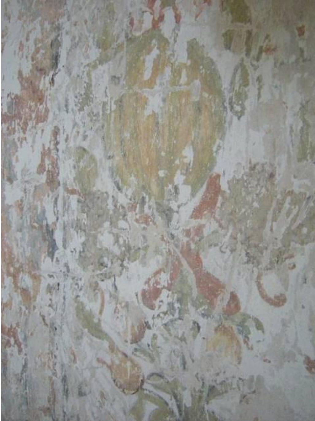
47. Pintura ornamental, muro 3 del ábside de la iglesia, convento de Santa Clara de Asís, Dzidzantún, Yucatán, septiembre, 2009
