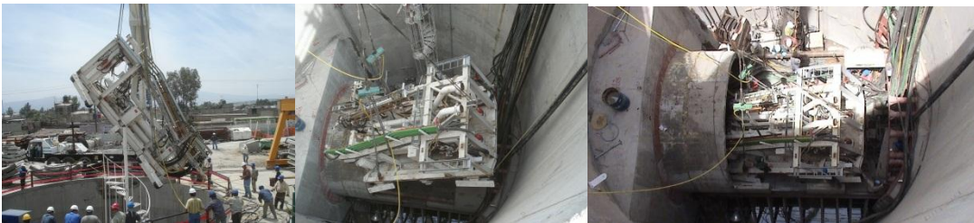
FIGURA 5.5 BAJADA DEL CARRO 1 (CARRO DE BOMBAS)
