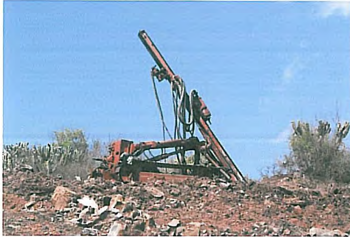
EXPLOSION DE BANCO (BANCO DECA KM 11+760 LAD O IZQUIERDO)
