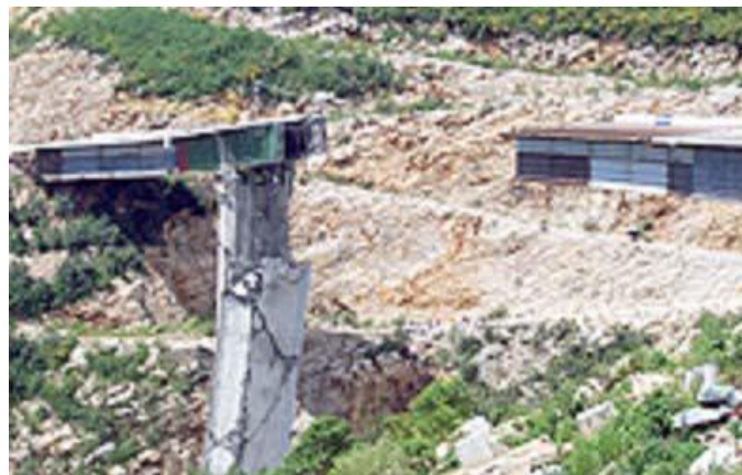
Figura 5.6: Colapso de la mitad del puente San Cristóbal (Notimex, 2004)
