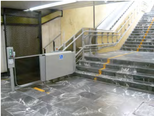
Rampa de ascenso y descenso de discapacitados en la estación de metro de Indios Verdes. Fuente: www.metro.df.gob.mx/
