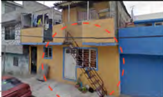
OBSTRUCCIÓN POR AUTOCONSTRUCCIÓN
