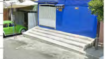
OBSTRUCCION POR AUTOCONSTRUCCION
