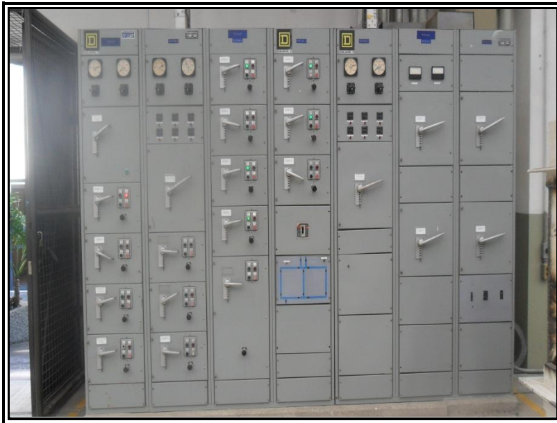
Figura 45. Caseta de control de bombas.
