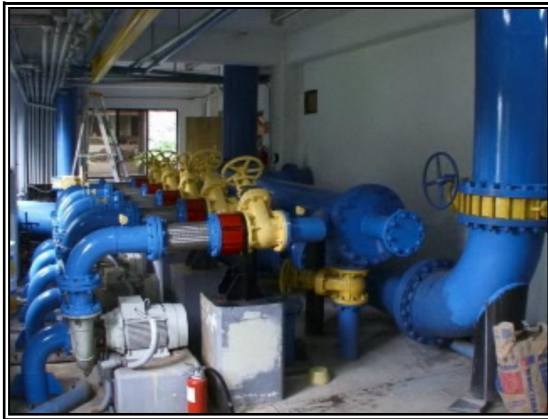
Figura 28. Cuarto de máquinas.
