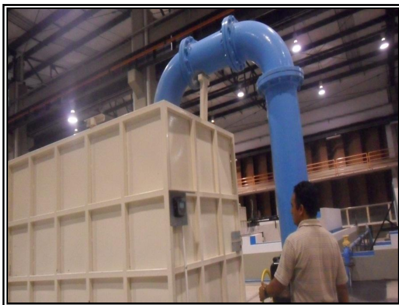
Figura 46. Abertura de válvulas para alimentar al sistema.
