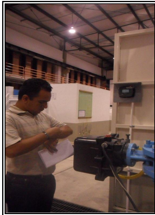
Figura 48. Registro de gastos del medidor electromagnético.
